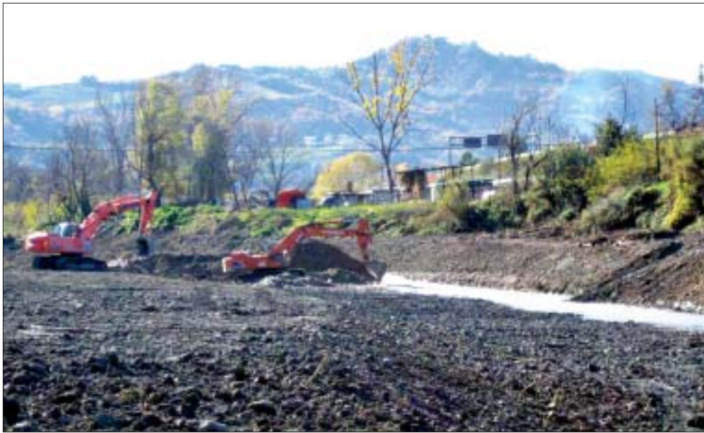
La malgestione delle risorse idriche è alla base di eventi disastrosi; nella foto, delle scavatrici eliminano un'ansa del fiume Tordino, nei pressi di Teramo, mutandone così la struttura del letto, la portata e la velocità delle acque. In apertura, il logo dell'Anno della Biodiversità
