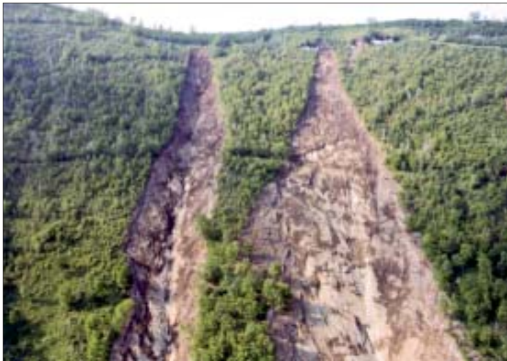
Questa drammatica immagine evidenzia le conseguenze della cessata manutenzione dei canali di drenaggio, utilizzati fin dal tempo dei Borbone e denominati “regi laghi” , sulle pendici delle montagne di Sarno, in Campania
